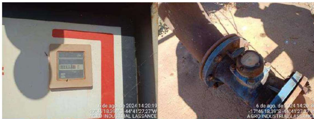
Figura 4: Evidências dos sistemas de medição instalados
