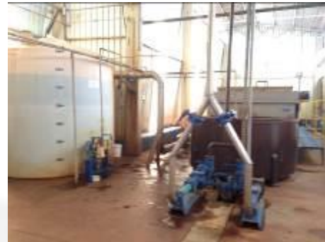
Foto 06. Tratamento primário (físico químico).
