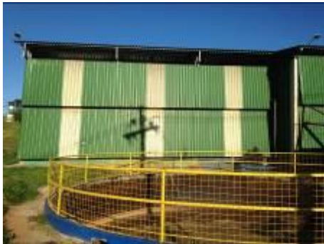
Foto 05. Central de controle da ETE.
