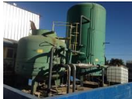
Foto 02. Estação de tratamento de água.
