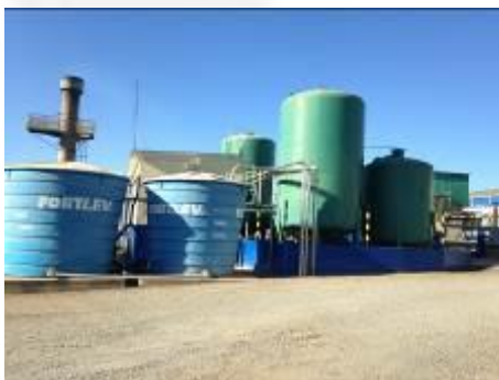
Foto 03. Estação de tratamento de água para reaproveitamento.
