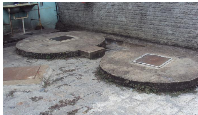
Foto 07. Sistema de Tratamento de Efluente líquido sanitário, composto de fossa séptica, filtro anaeróbico e rede pública.
