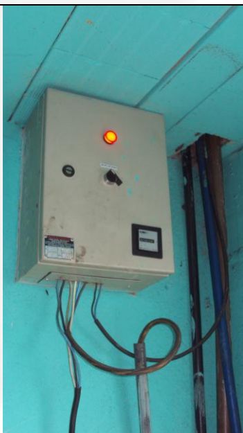
Foto 09. Hidrômetro e horímetro já instalados.
