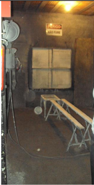
Foto 4. Cabine de pintura.
