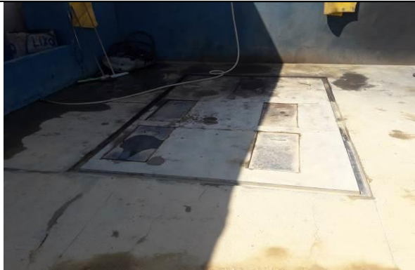
Foto 07: Caixa SAO – Casa das máquinas
