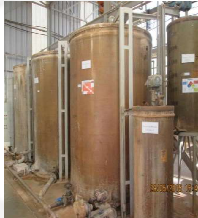
Foto 19: tanques com produtos químicos que controlam a turbidez e a acidez da barragem de rejeito
