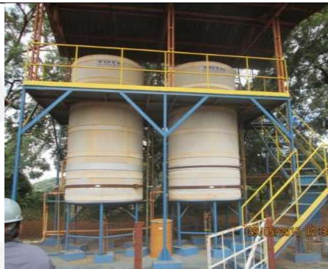
Foto 16: estação de tratamento de esgotos da unidade
