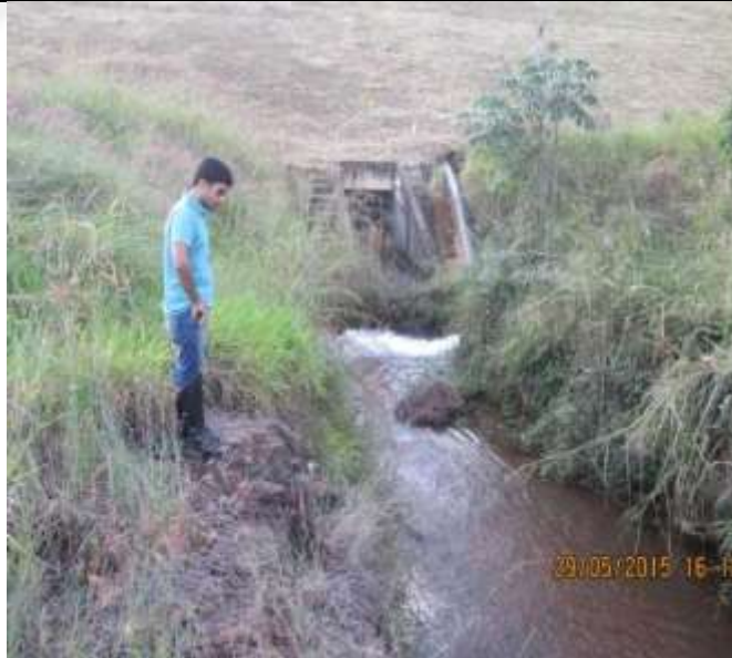
Foto 23: base (pé) do barramento vertendo água da barragem de rejeitos
