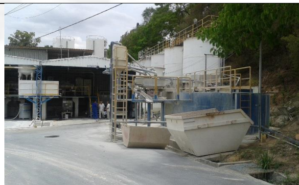
Foto 02: vista da ETEI.
