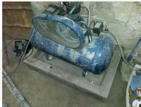
Foto 10: Compressor com bacia de contenção.
