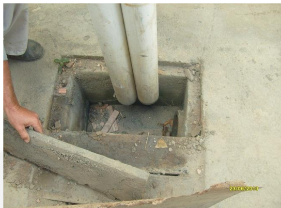
Foto 12: Caixa de sedimentação – drenagem pluvial.
