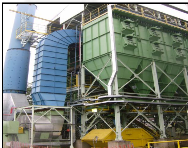
Foto 03. Equipamentos para desempoeiramento no transporte de carvão (filtro de mangas).
