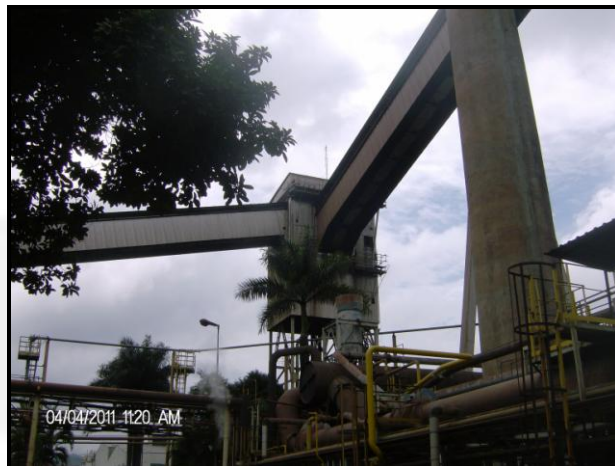
Foto 02. Correias transportadoras de transposição e sistema de desempoeiramento (Bin Vents).
