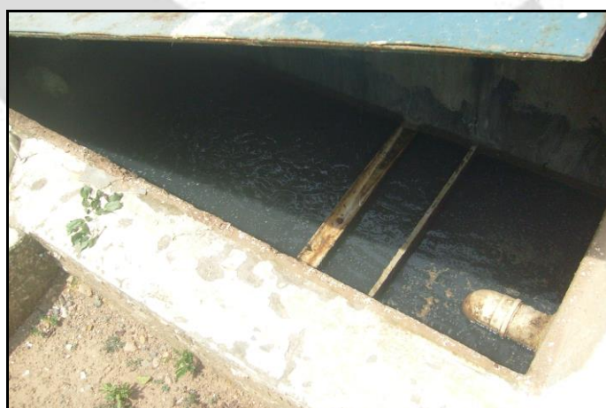
Foto 08: Caixa SAO para receber o efluente gerado no lavador de veículos.
