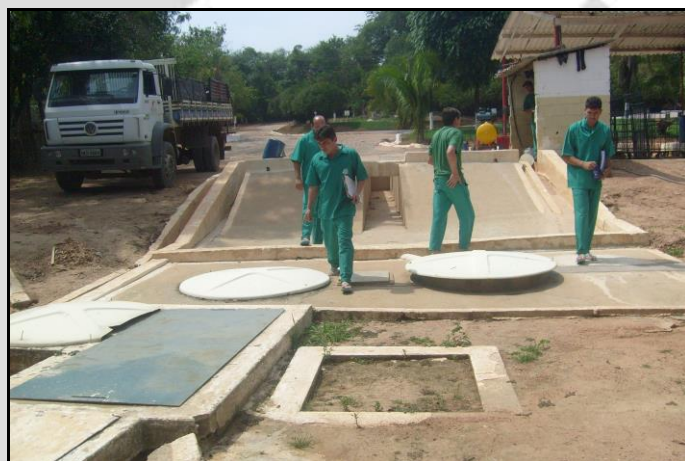
Foto 07: Caixa SAO para receber o efluente gerado no lavador de veículos.
