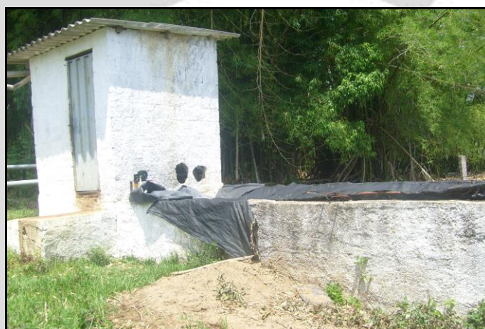
Foto 01: Local da casa de máquina onde estão instalados o conjunto motobomba para captação superficial no ribeirão empanturrado, requerida por meio do processo de outorga nº 10981/2015.
