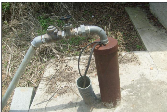
Foto 03: Identificação do poço 2 para exploração do recurso hídrico requerido no processo de outorga nº 10985/2015. Verifica-se que a laje de proteção sanitária está instalada.
