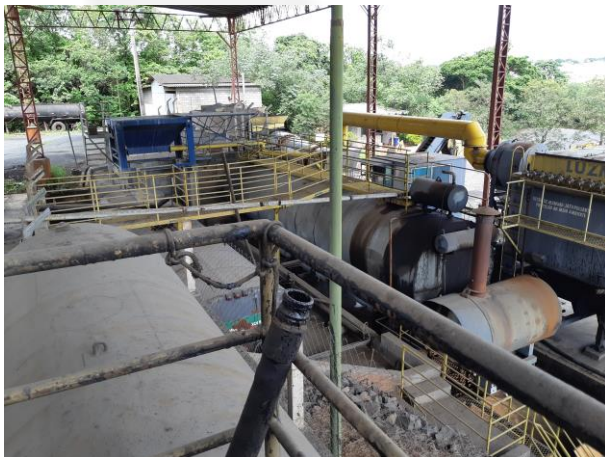
Foto 03. Vista geral (tanque de CAP, caldeira e UA 200)
