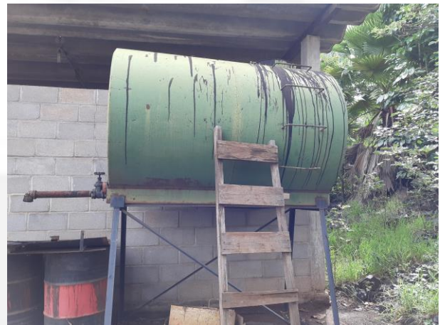
Foto 04. Tanque utilizado para armazenamento de emulsão asfáltica nas obras
