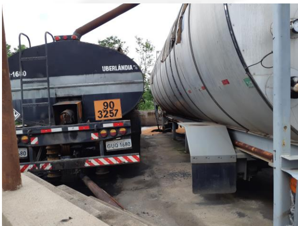
Foto 13. Tanques dentro de bacia de Contenção
