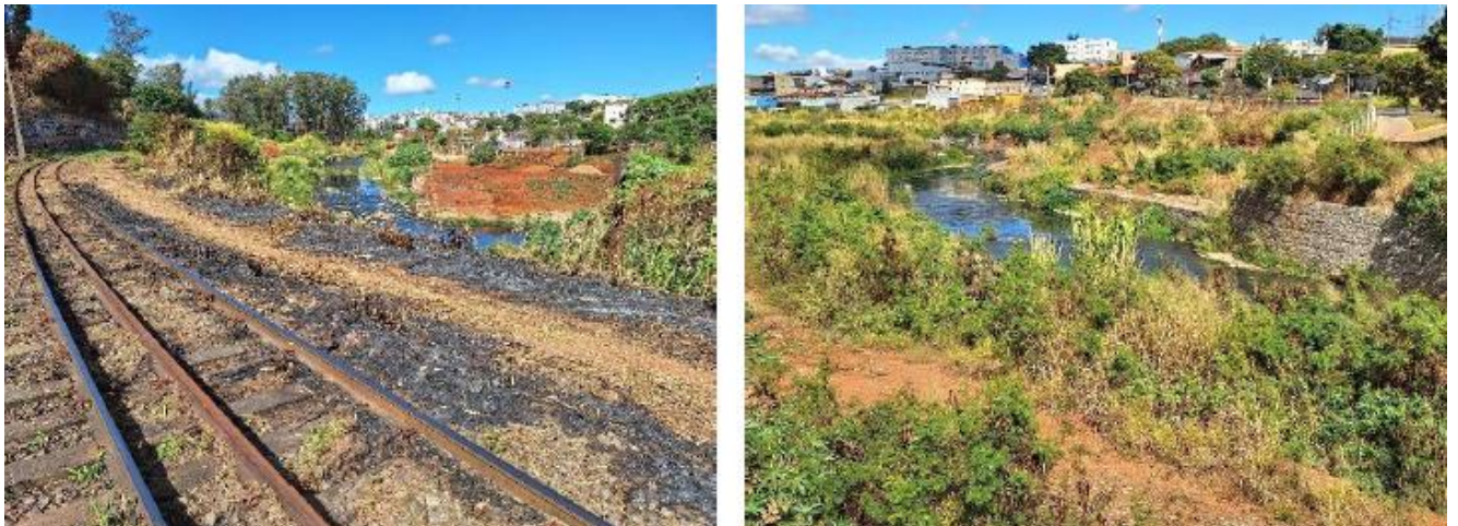
Figura 07 – Vista geral e próxima do ribeirão Arrudas e estruturas (gabião) ao fundo. Fonte: RCA - METRÔ BH, 2024.
