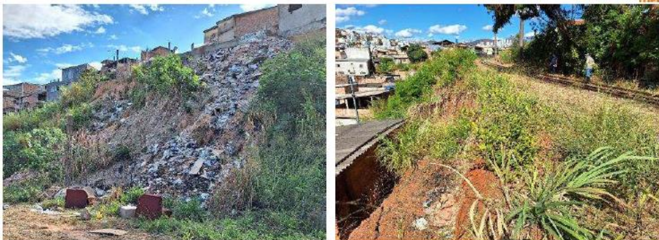
Figura 05 - Trechos com edificações situadas nas encostas de morro e taludes no entorno da faixa de domínio da Linha 2 . Fonte: RCA – METRÔ BH, 2024.
