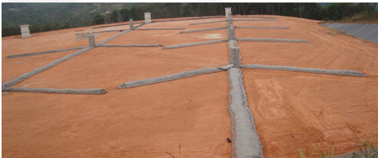
Figura 8 - Drenos DEH e DEV, na forma de espinhas-de-peixe, instalados na base da Unidade de Aterragem de um aterro sanitário (Foto meramente ilustrativa)
