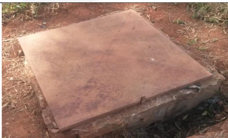
Poço de monitoramento de águas subterrâneas (PMM-01)
