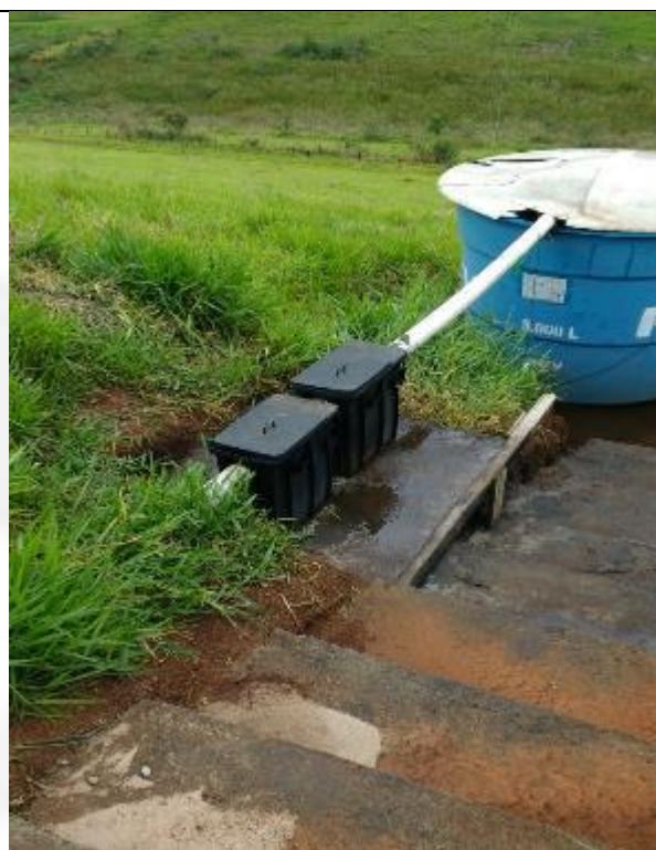
Tratamento de efluentes
