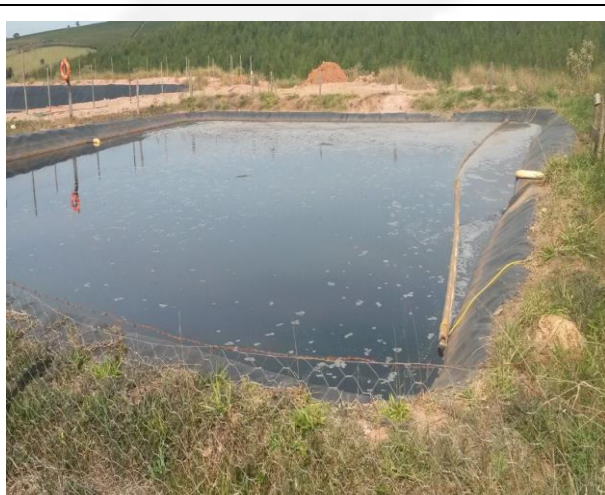
Figura 11 - Lagoa anaeróbia da ETE. (Fonte: Aterro Sanitário de Alfenas, 2015)
