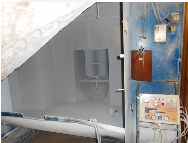
Foto 03. Área de pintura com exaustor e filtro
