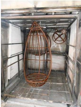
Foto 05. Estufa para fixação da pintura eletrostática
