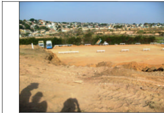
Foto 17. Área desmatada, sem autorização estadual, para construção de novo galpão.
