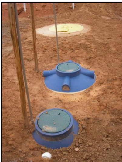
Foto 01: Sistema de tratamento do efluente sanitário no canteiro de obras.
