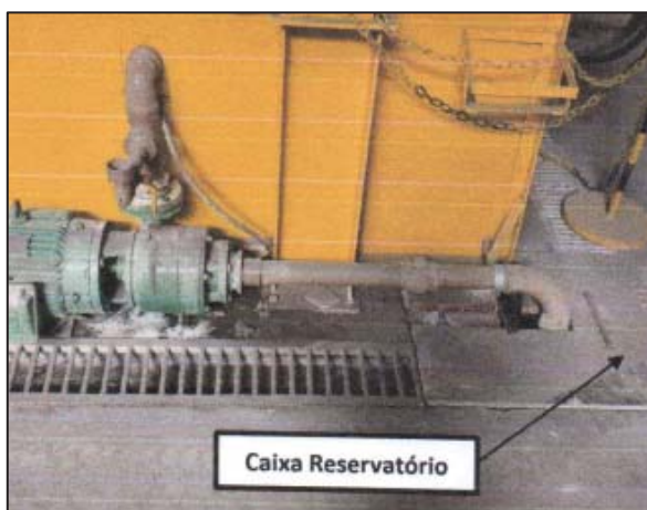
FIGURA 3(a) – Reservatório dos efluentes das caixas SAO do setor de retíficas.
