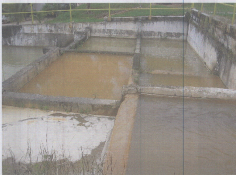
Foto 6. Estação de Tratamento de Água.
