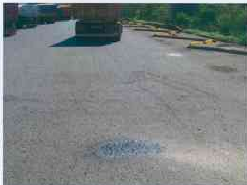
Figura 10 – Fotografia 04 – No período em que os caminhões estão estacionados as vezes ocorrem pequenos vazamentos ou reparações na parte mecânica que produzem perdas de substâncias ou resíduos mais agressivos ao meio ambiente tais como óleos e combustíveis. Notar a pequena mancha de óleo juntamente com uma pequena perda de grãos.
