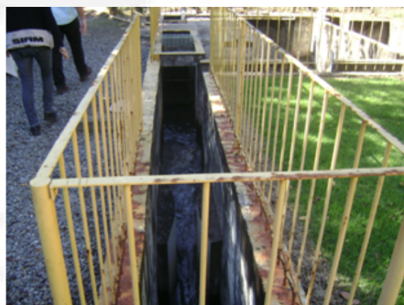
Foto 02. Calha Parshall - entrada do efluente
