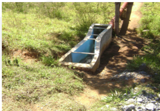
Foto 04. Calha Parshall - saída do efluente
