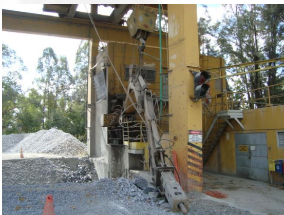
Foto 05. Rompedor hidráulico acoplado na alimentação da planta de britagem.
