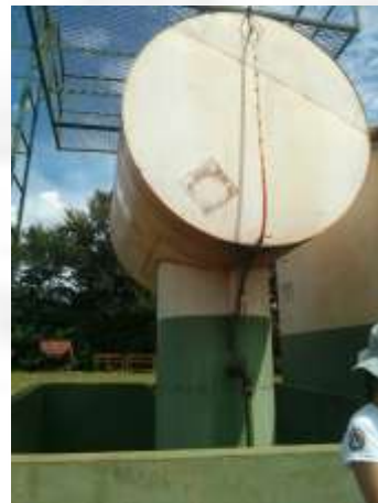
Foto 08. Tanque de armazenamento de combustível
