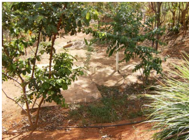
Foto 01. Fossa séptica no empreendimento.
