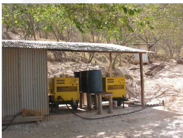
Foto 03. Compressores utilizados no empreendimento.
