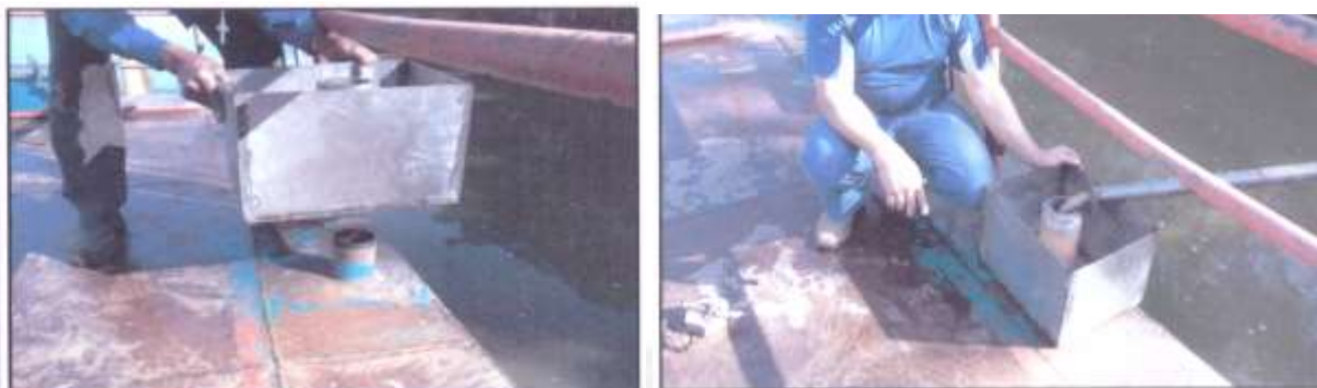
Figura 11 - Sistema de contenção contra vazamentos no abastecimento da draga.
