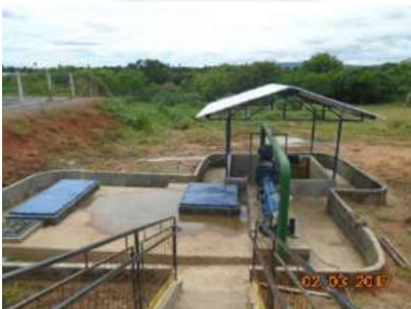
Foto 07. Elevatória da linha verde
