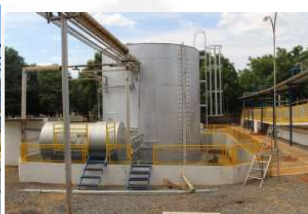
Foto 10. Tanques de armazenamento de diesel e BPF inativos
