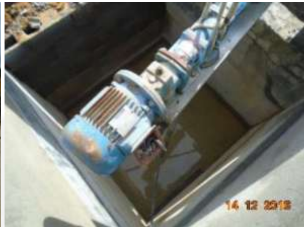
Foto 06. Bomba chorume da composteira
