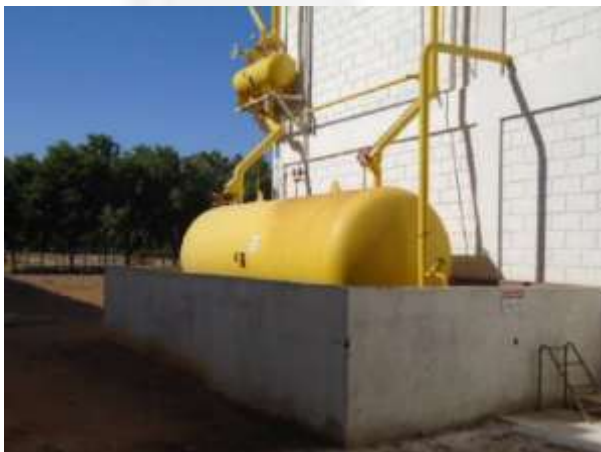
Foto 03. Tanque de amônia
