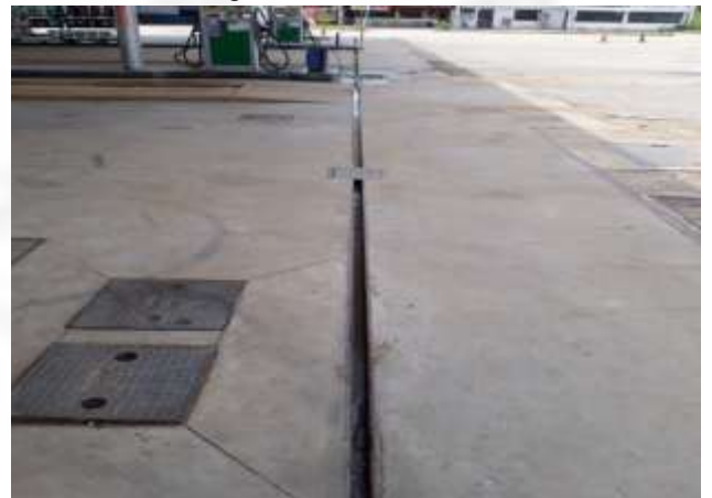
Foto 04: Detalhe da canaleta de contenção em torno da pista de abastecimento e dentro da projeção da cobertura.
