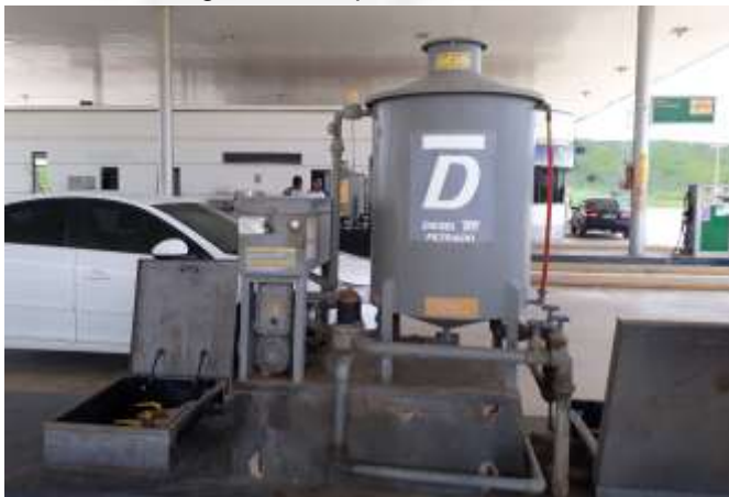
Foto 03: Filtro de diesel dotado de bacia de contenção e dentro da cobertura da pista de abastecimento.
