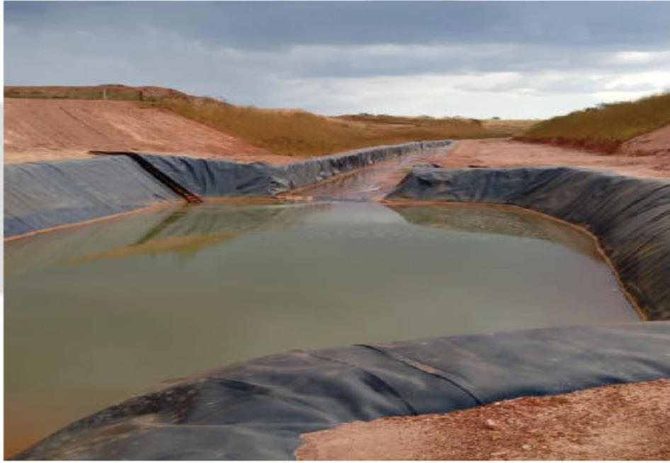
na de drenagem pluvial e bolsão de sedimentação em manta
