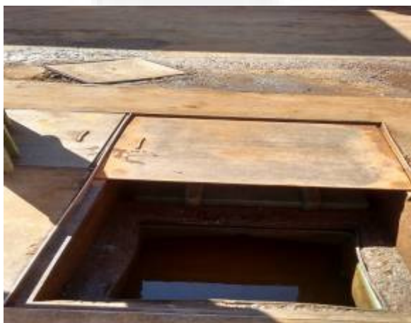
Foto 03. Caixa Separadora de Água e Óleo do posto
