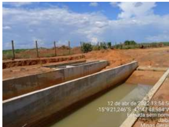
Foto 12 - Tanque de decantação do lavador
