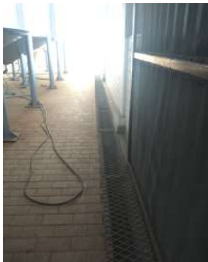
Foto 6 - Canaletas de recolhimento de efluentes
