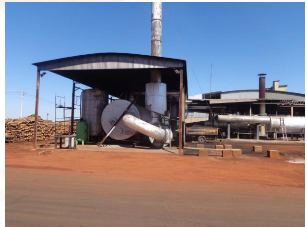
Foto 02. Área das caldeiras
