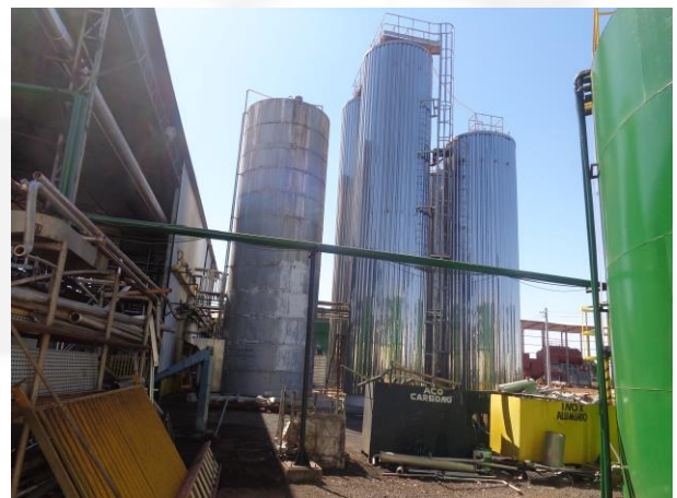
Foto 04. Tanques de armazenamento
