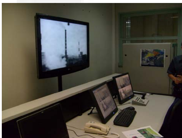
Foto 03. Centro supervisorio – sistema de monitoramento visual das chaminés.
