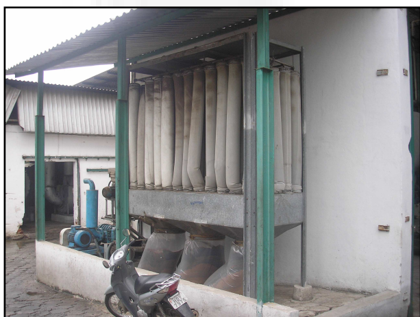
Foto 05: Filtro de manga do setor de lixamento.
