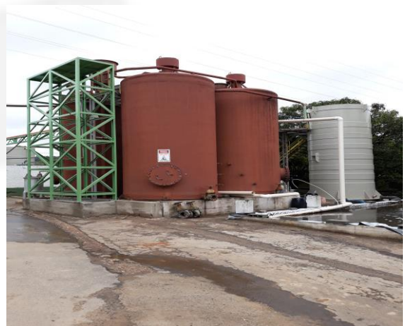
Foto 06: Vista da ETE.
