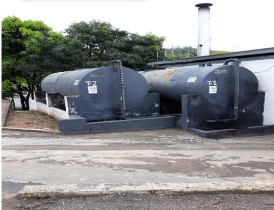
Foto 03: Tanques de armazenamento de óleo.
