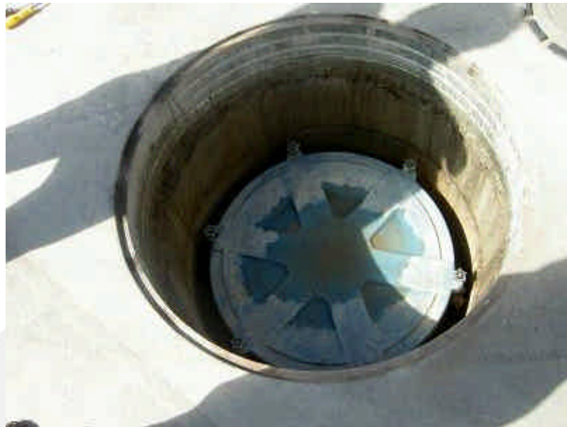
Foto 05: Boca de visita.
