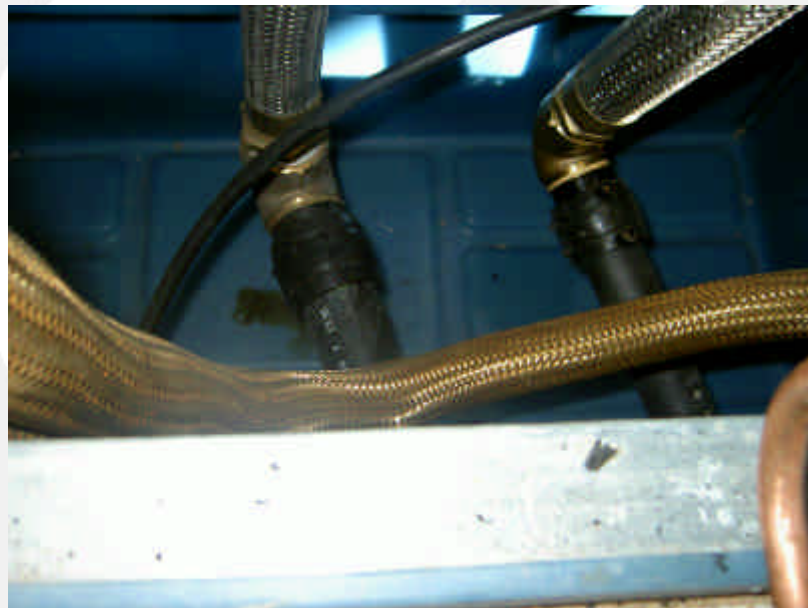
Foto 04: Tubulação em PEAD e Sump da bomba.
