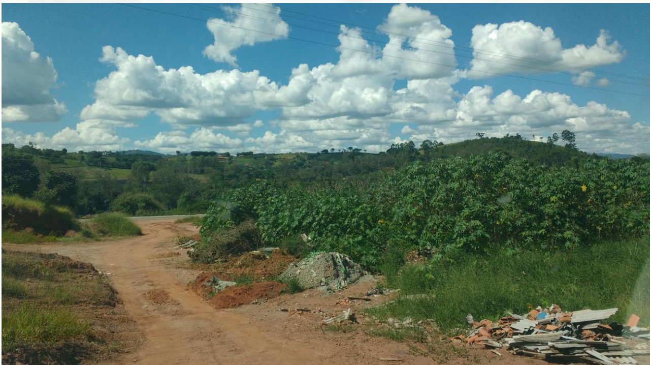
Resíduos de construção civil disposto inadequadamente
