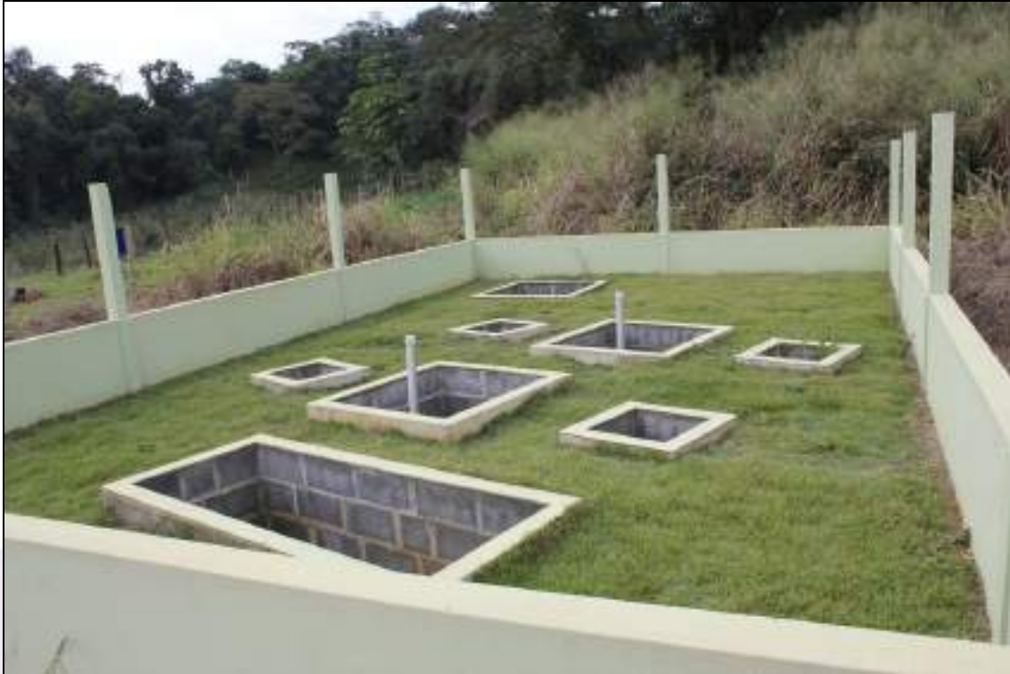
Foto 02: Vista para Unidade de Tratamento de Efluentes Sanitários da AGRO-CAMPO
