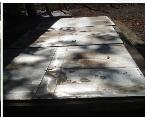
Foto 4: Caixa de gordura
