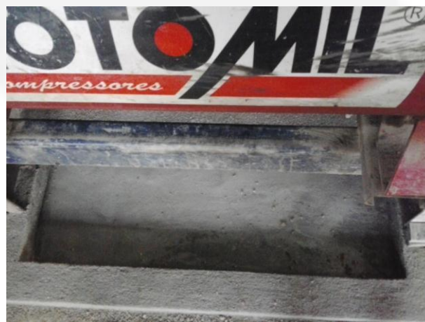
Foto 15: Compressor com bacia de contenção.
