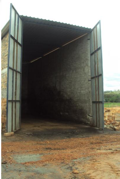
Foto 3: Depósito de pó de balão.
