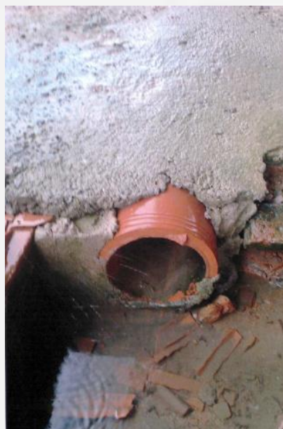
Foto 13: Caixa da sedimentação do sistema de drenagem pluvial.
