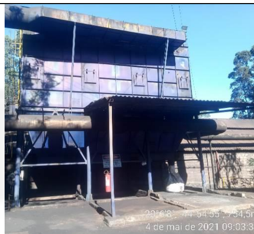
Foto 02. Filtro de mangas.
