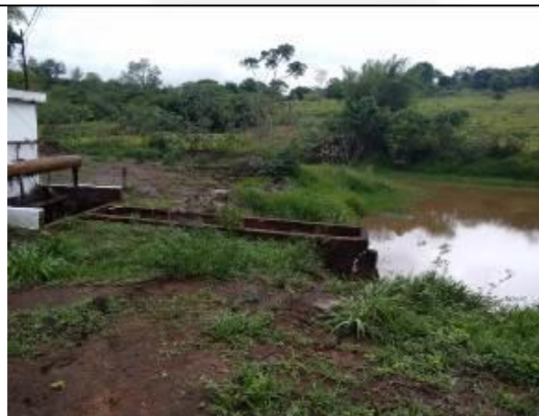
Foto 05. Captação de água superficial no barramento.
