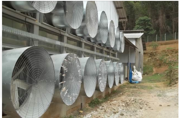
Foto 02. Sistema de climatização.
