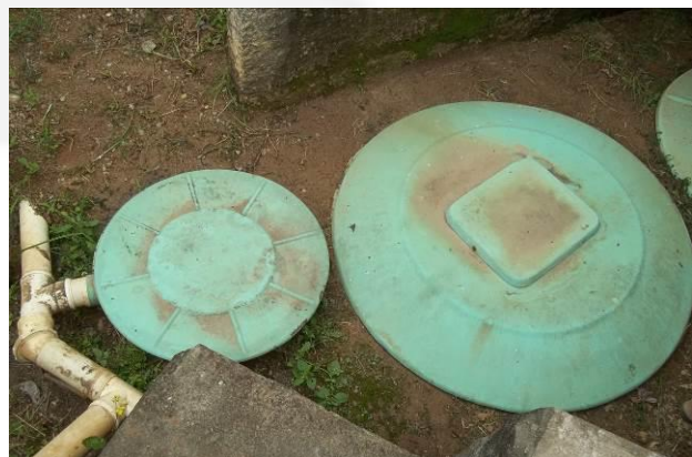
Foto 06. Tratamento de efluentes sanitários.
