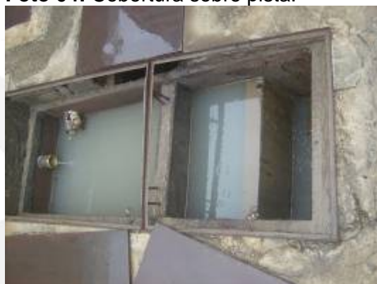
Foto 06: Caixa SÃO de Alvenaria.
