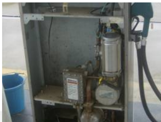
Foto 02: Bomba de abastecimento.
