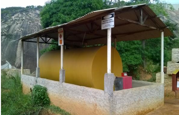
Foto 7. Tanque de abastecimento.
