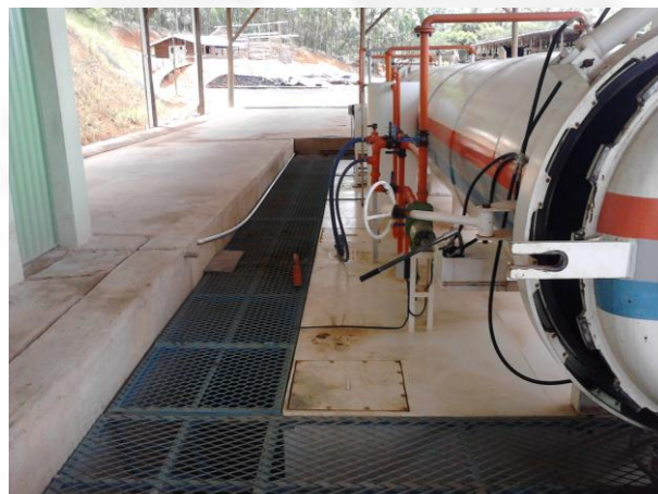
Foto 04. Área da Autoclave.
