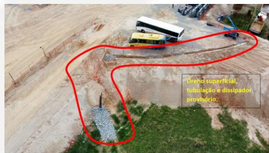
Vista superior do sistema de drenagem.
