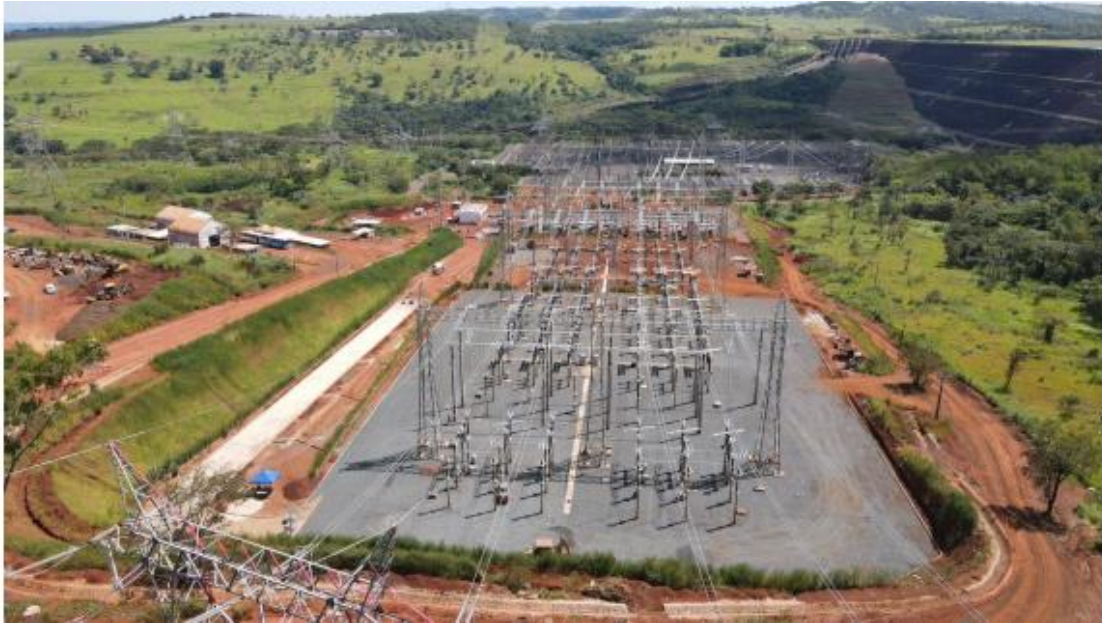
FIGURA 2.5: 500 KV NOVA PONTE – NOVO PÁTIO 345 KV E TRANSFORMAÇÃO 500/345 KV. FONTE: RT DE SITUAÇÃO, 2023
