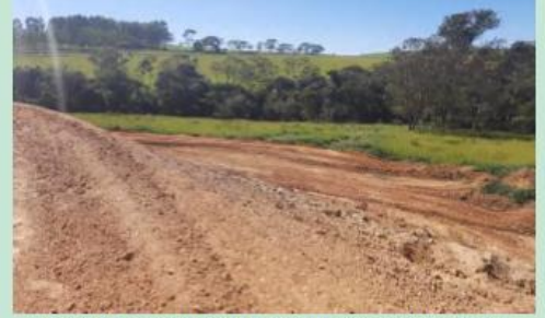
Foto 4.1-46: Evidência fotográfica da construção de contenções, dissipadores de energia em locais estratégicos, diques de contenção/curvas de níveis na área de menor declive afim de diminuir a força da água.
