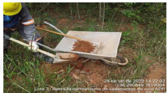
Retirada de sedimento carreado.
