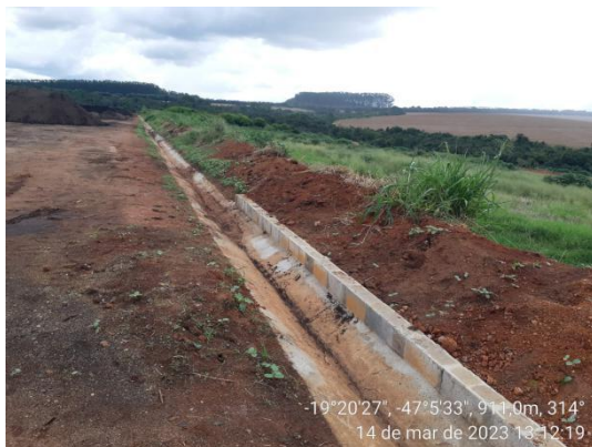
Foto 3. Canaleta de drenagem no pátio de compostagem
