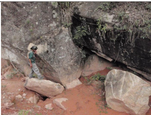
Foto 9: Porção de entrada da cavidade que continua sofrendo impacto irreversível em função de efluentes oriundos de atividade mineradora a montante
