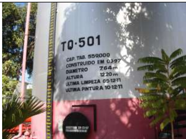
Foto 07 – TQ 501 Água para combate a incêndio
