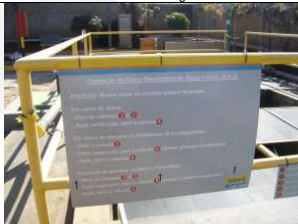
Foto 06 – Caixa separadora de água e óleo
