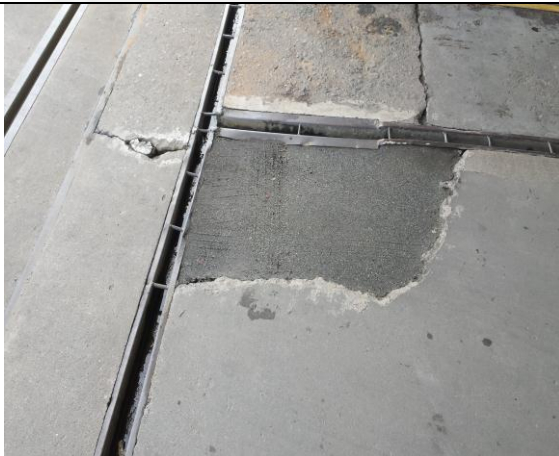
Foto 02. Presença de rachaduras no piso de abastecimento de veículos
