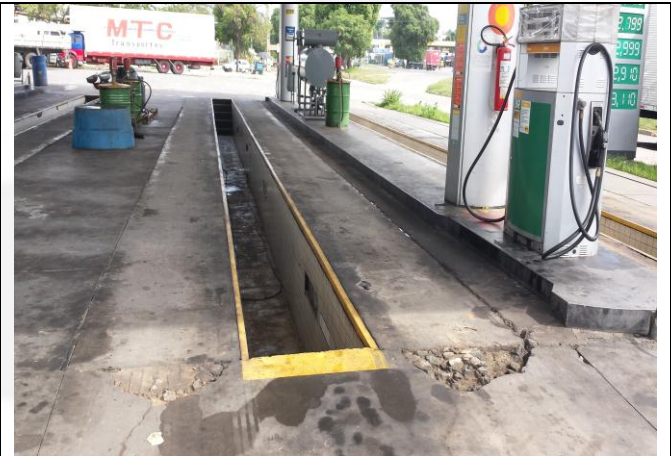
Foto 03. Presença de rachaduras no piso de abastecimento de veículos
