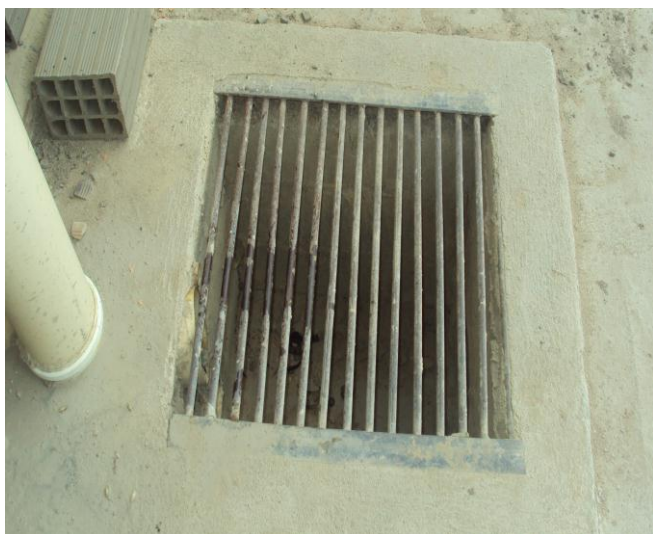
Foto 13: Sistema de drenagem pluvial
