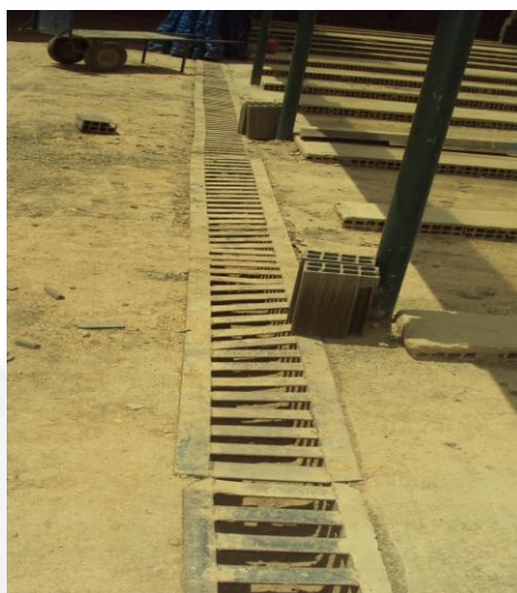
Foto 14: Sistema de drenagem pluvial
