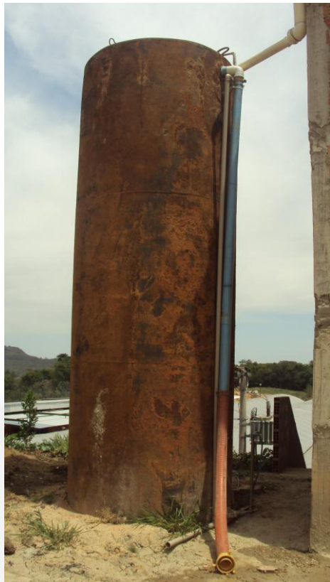
Foto 9: Torre de armazenamento de água pluvial proveniente do depósito de pó de balão
