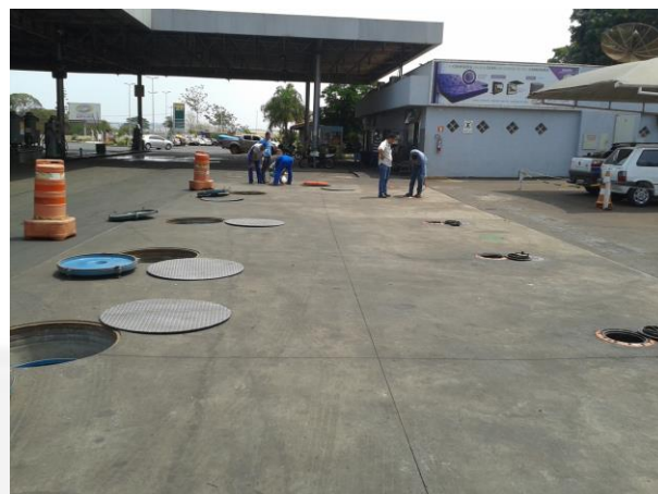
Foto 06. Área de tanques da pista de caminhões
