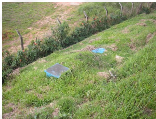
Foto 04. Fossa séptica do empreendimento.
